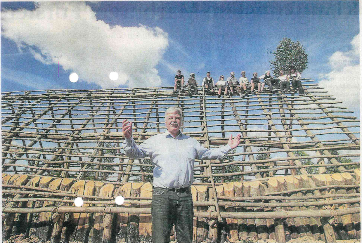
„Das ist der erste Akt in diesem Theater“, sagt Weimars Bürgermeister Peter Eidam beim Richtfest auf der Zeiteninsel in Argenstein.
